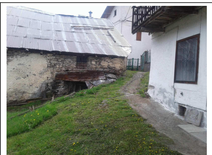
Via pubblica "Gli Orti" – fenomeni di erosione superficiale
