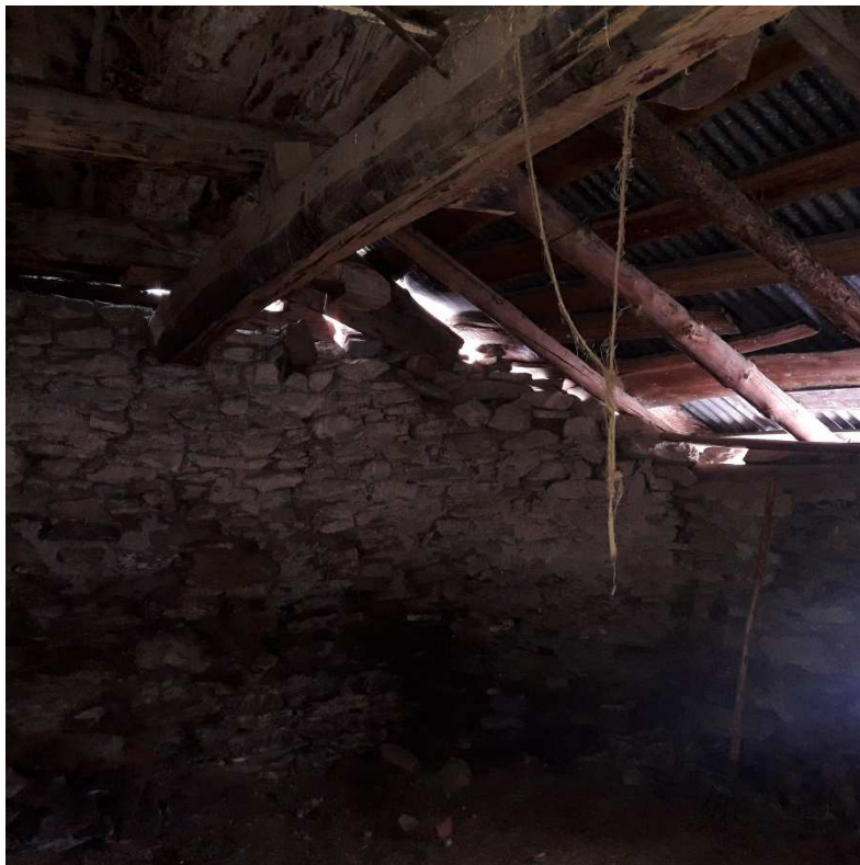
Dissesti nella zona di imposta del tetto
